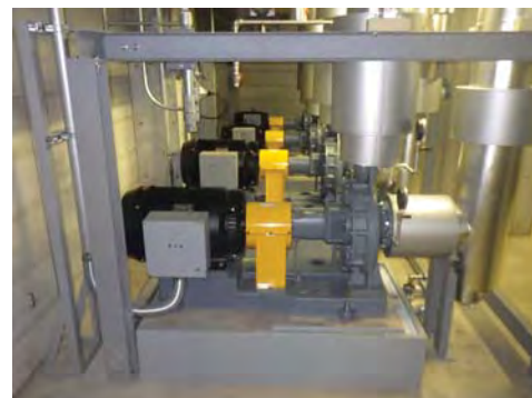
更新した冷温水ポンプ
