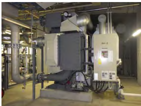
更新した吸収式冷温水発生機
