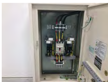
新設の控室イベント盤
