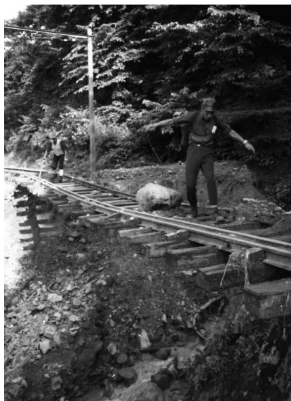
富山地方鉄道立山線の甚大な被害
