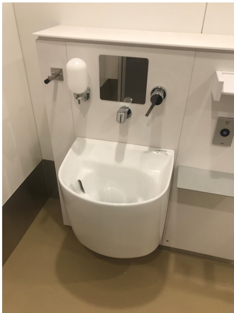
<オストメイト対応水栓設備>
