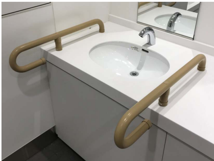
<手摺付き洗面カウンター>
