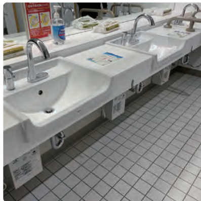
車椅子使用者がより近づけるよう足元のスペースを確保した洗面台を設置 自動吐水と押しボタン吐水の切替え、温冷の切替えが可能な水栓を設置
