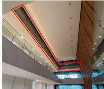
崩落した4階下がり壁
