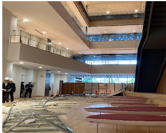
写真2 1階エントランス（事故発生後）
