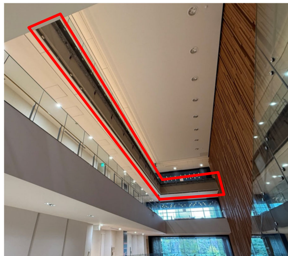
写真4 吹き抜け4階下がり壁（崩落後）
