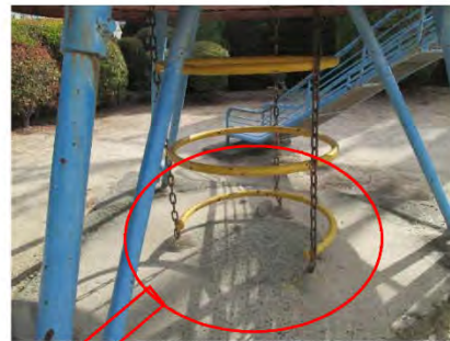
コンクリートの露出状況
