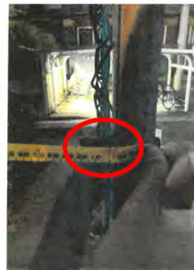
ボルト突出状況
