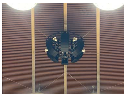
天井スピーカーの耐震対策
